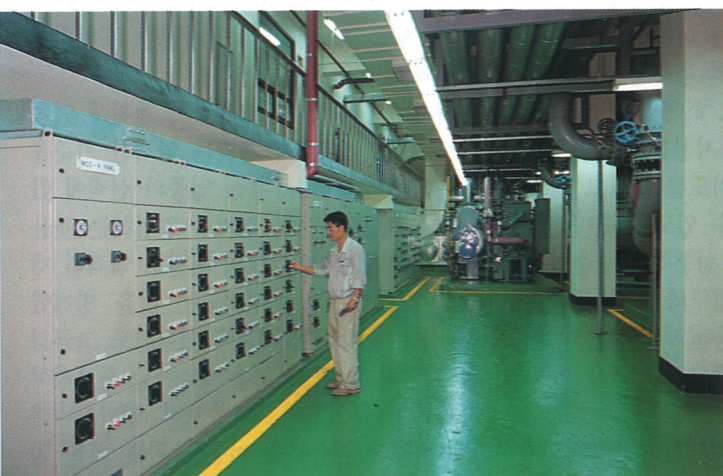
지하 6층 기계실
