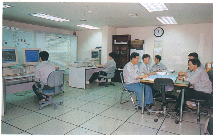
지하 6층 중앙감시실
